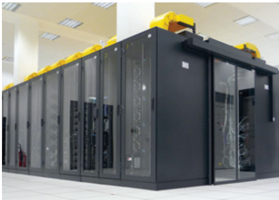
Mesure et contrôle
